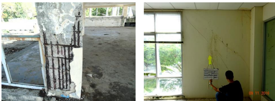
รูปที่ 3 การสำรวจความเสียหายรอยแตกร้าวของโครงสร้าง
