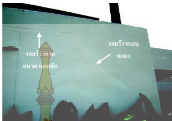
รูปที่ 1.2 รอยร้าวบริเวณผนังด้านนอกของอาคาร
