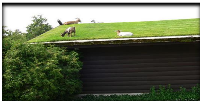
รูปที่ 1: สภาพแวดล้อมของหลังคา Green Roof
