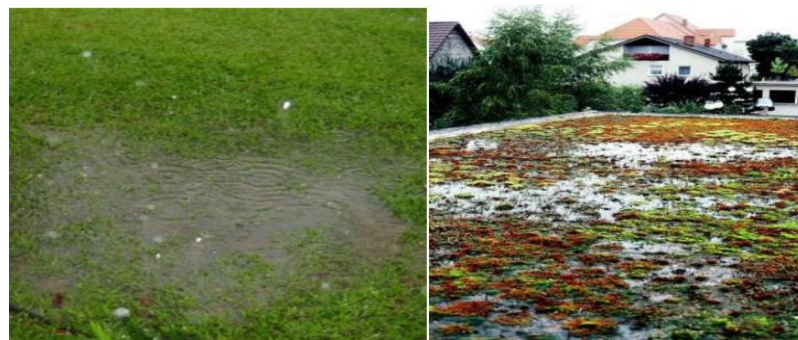
รูปที่ 3: ปัญหาการท่วมขังของหลังคา Green Roof
