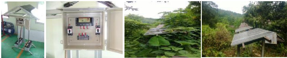
รูปที่ 2 การพัฒนาการใช้งานระบบกลุ่มของเซลล์แสงอาทิตย์สำหรับไฟฟ้าแสงสว่างภายในหมู่บ้าน แบบ Stand alone และการฟื้นฟูปรับปรุงแผงเซลล์แสงอาทิตย์ ที่หน่วยงานของรัฐ ติดตั้งไว้แต่ขาดการดูแลรักษา ให้กลับมาใช้ประโยชน์กับชุมชนได้ใหม่
