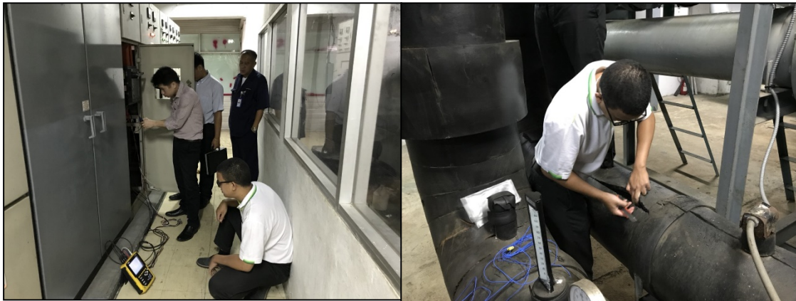
รูปที่ 2 การตรวจวัดประสิทธิภาพเครื่องทำน้ำเย็นขนาด 1,000 ตัน
