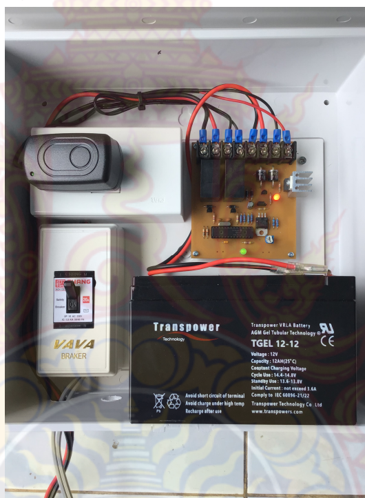
ภาพที่ 24 การประกอบอุปกรณ์ทั้งหมดลงตู้ควบคุม
