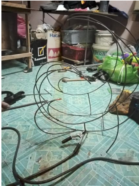
ภาพที่ ๒๒ ภาพขั้นตอนการเชื่อมส่วนต่อโครงสร้าง
