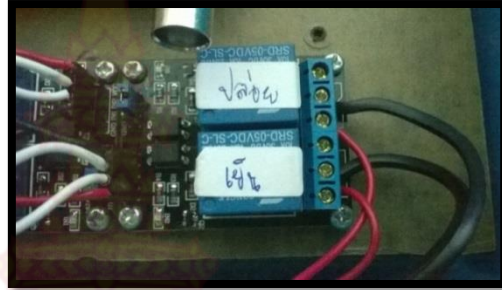
ภาพที่ 28 ติดตั้ง Relay Module ตัวที่ 1
