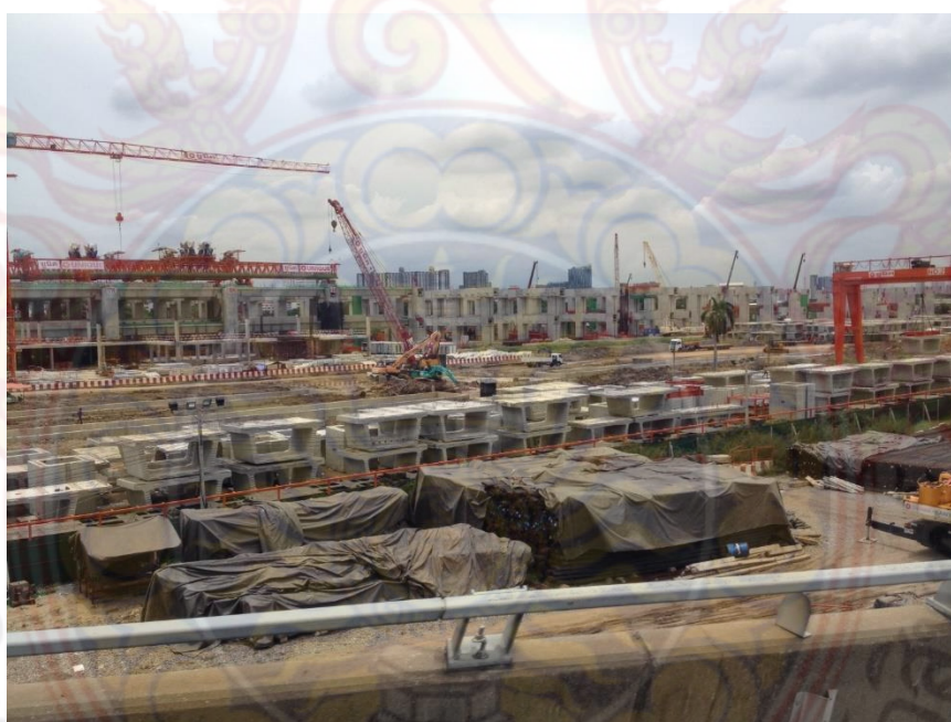
ภาพที่ 2 : การก่อสร้างเส้นทางคมนาคม ที่มา : ข้อมูลจากผู้เขียน
